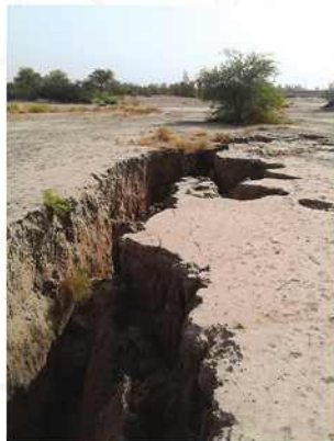
شکل ۲) نمونه‌هایی از نشست زمین [۵]
